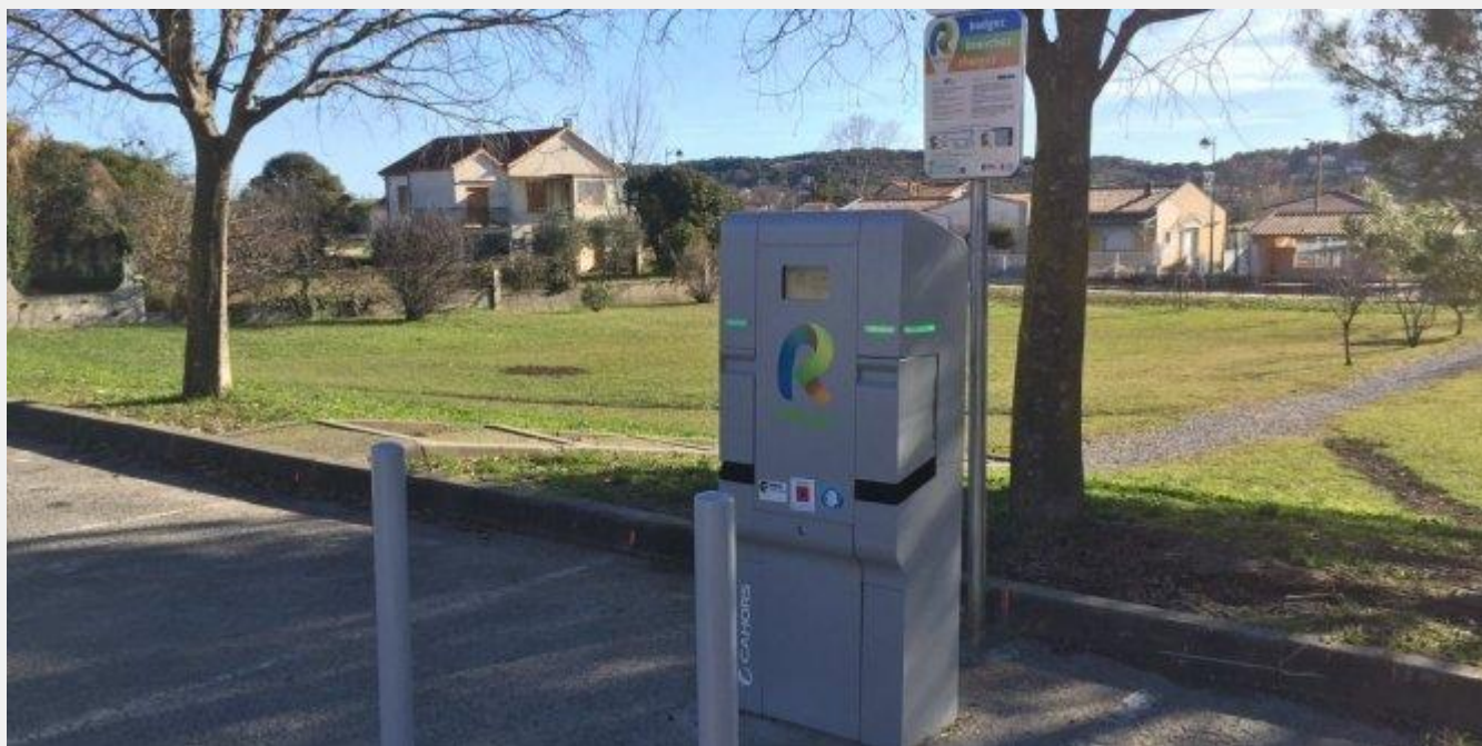
La borne de rechargement électrique à Mazac
